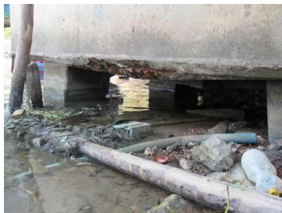
(ฉ) ฐานราก กะเทาะหลุดล่อนจนเห็นเหล็กเสริม
