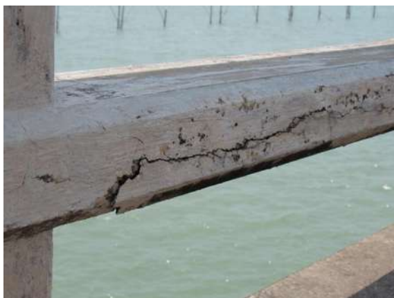
(ค) ร้าวสะพาน เกิดรอยแตกขนาดเล็ก
