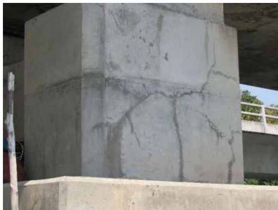
(ง) เสาคอม่อ พบรอยแตกขนาดเล็ก
