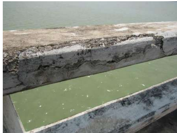
(ข) ร้าวสะพาน หลุดล่อนเล็กน้อย
