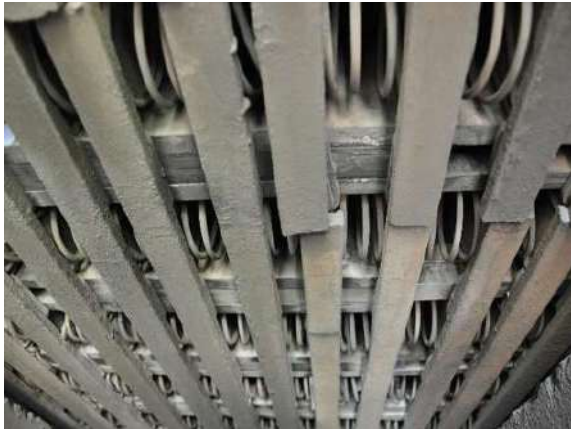
(ข) Modular Joint ชำรุดเสียหายบางส่วน
