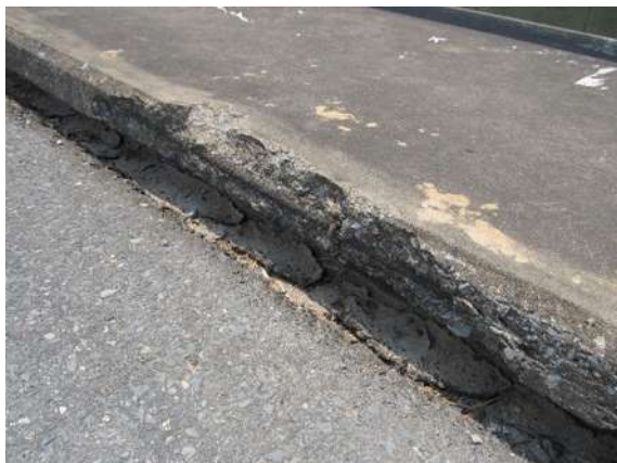
(จ) ทางเท้า หลุดล่อนเห็นเหล็กเสริมบริเวณกว้าง
