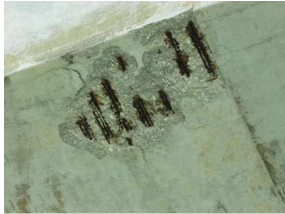
(ง) คานสะพาน หลุดล่อนจนเห็นเหล็กเสริมบริเวณกว้าง
