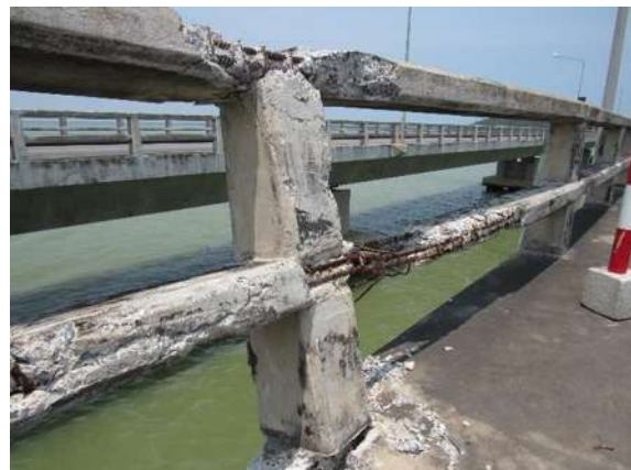
(ฉ) ร้าวสะพานไม่สามารถใช้งานได้ปกติ
