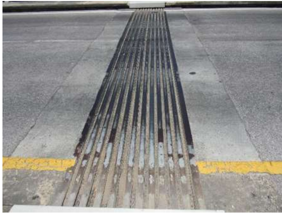
(ค) รอยต่อสะพาน พบรอยแตกตามแนวรอยต่อ
