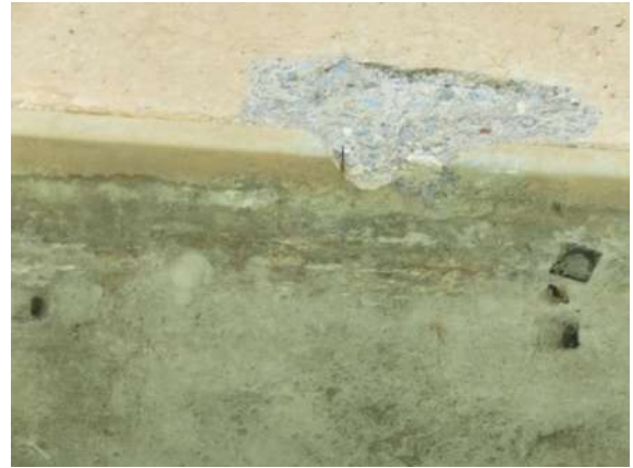
(ค) คานสะพาน หลุดล่อนบริเวณแคบ
