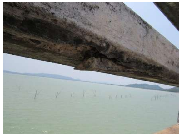
(ง) ร้าวสะพาน เกิดรอยแตกขนาดกลาง
