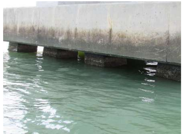
(ช) เสาค้ำยัน ดึงกร่อนบริเวณแคบ
